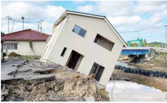
復旧の手が回らないのか、傾いたままの家屋＝石川県珠洲市
